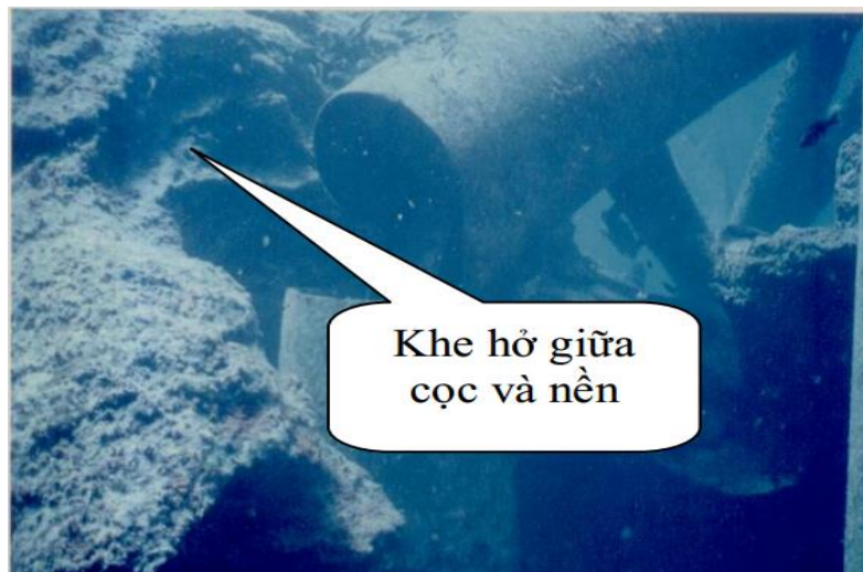
Hình 2.1. Chân cọc nhà giàn DKI/6 bị hư hỏng
